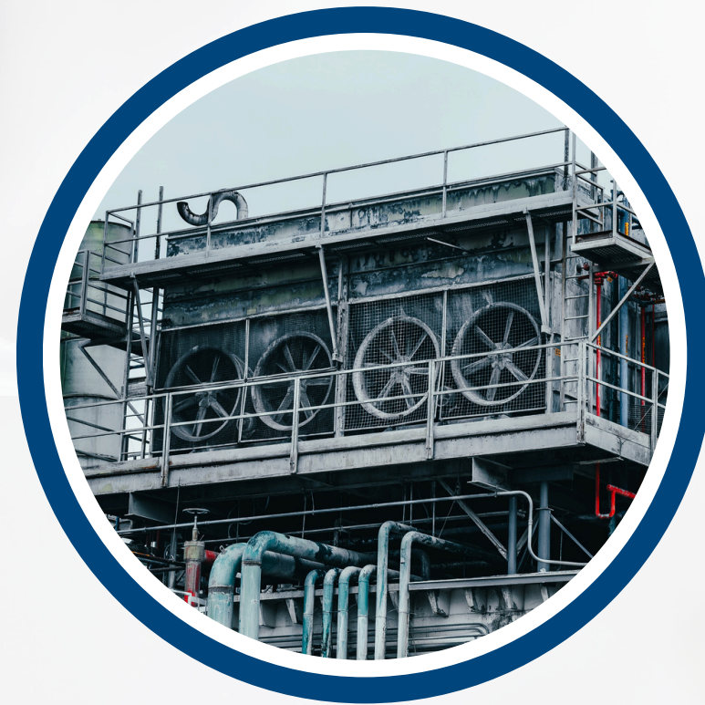
Systèmes de refroidissement et de traitement des liquides
